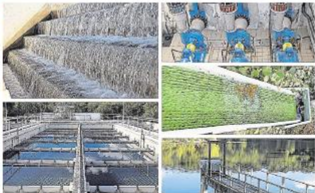
À gauche : l'eau est d'abord aérée dans une cascade artificielle, bassins de décantation, au fond desquels des grilles retiennent les flocons de boue. L'eau étant récupérée en surface. À droite : en fin de parcours, de puissantes pompes envoient l'eau vers le barrage du Futuau. La passe à anguilles : une gouttière à 45 degrés, plantée d'herbes synthétique et un courant d'eau qui permet aux anguilles de remonter. Une station de pompage de l'eau dans le lac.
